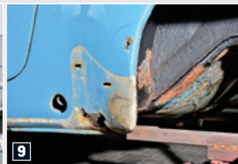
9 STEINSCHLAGSCHUTZ Ist der Ablauf verstopft, rostet das Blech hinter den Chromabdeckungen
